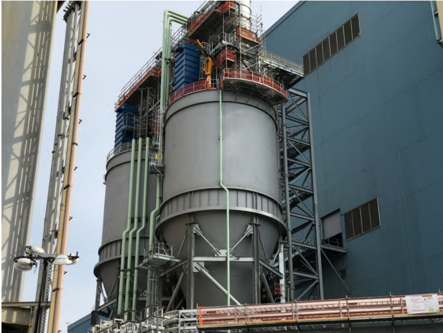
UCC Dry Bottom Ash Silos
